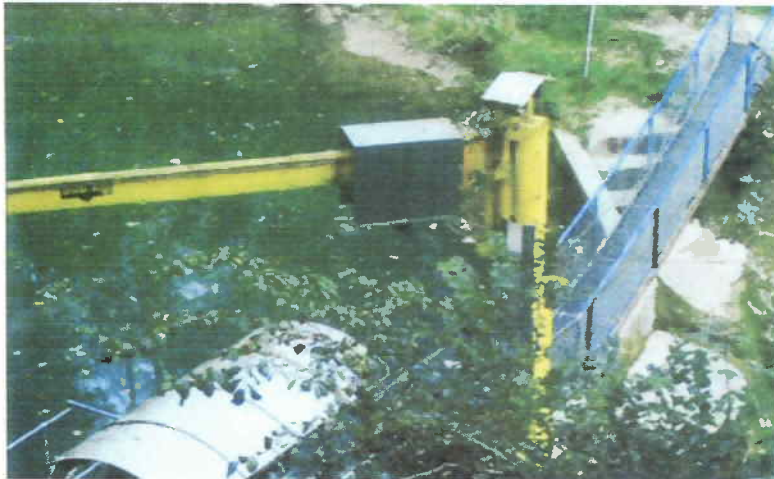
Technisch auf dem neuesten Stand: Das Stauwehr im Aabachtobel
