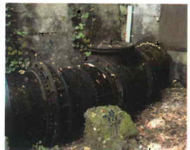
Sichtbare Teile der Druckleitung
