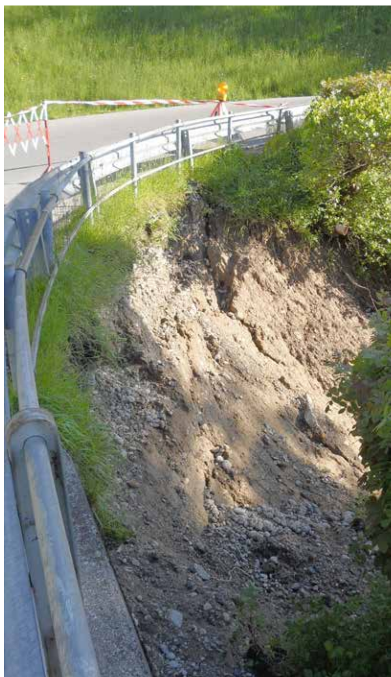
Schaden an Hintergoldingerstrasse
